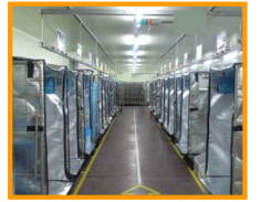
天吊り架台に設置
